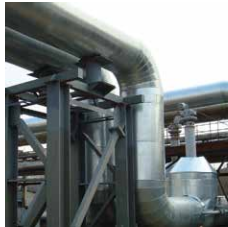
Системы вентиляции, кондиционирования и трубопроводы
